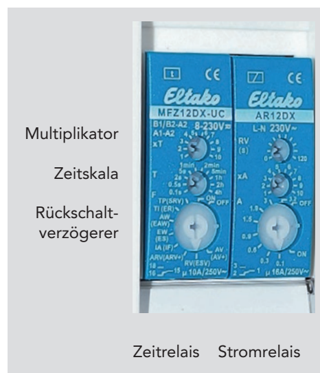
Zeit- und Nachlaufrelais auf der Rückseite des Geräteschranks, Einstellung der Nachlaufzeit des Lüfters
